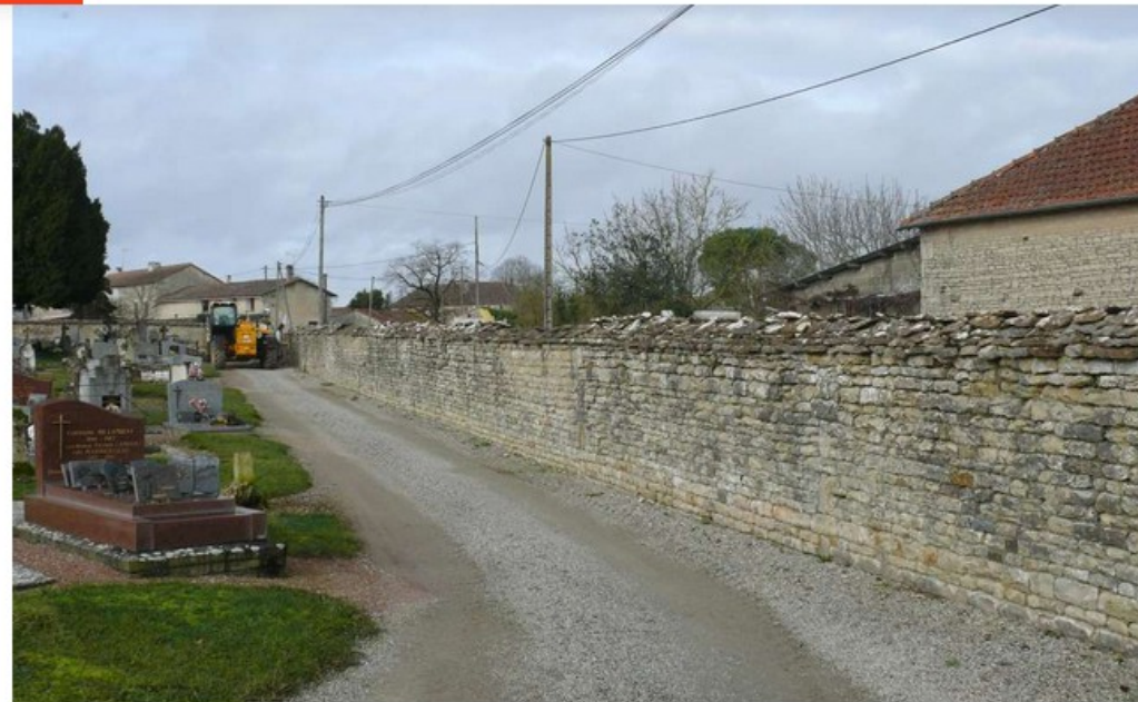
Le linolet a besoin d'une restauration.
